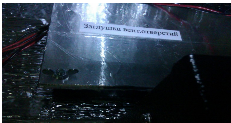
фото 7 — Заглушка вентиляционных отверстий верхнего отсека
